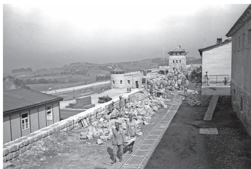
Prisoners working on the construction of the wall of the camp. © Museu d'Història de Catalunya. Fons fotogràfic de l'Amical de Mauthausen.
